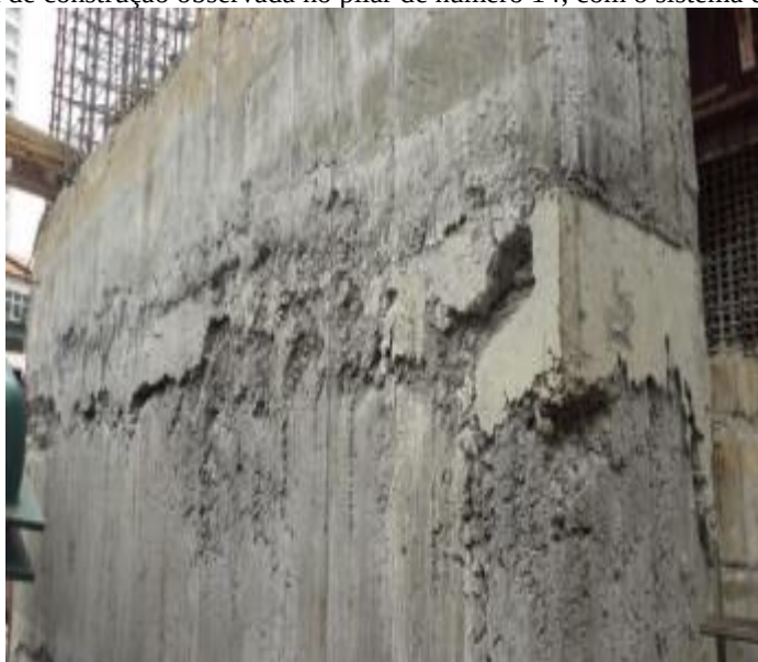
Figura 4 – Patologia de construção observada no pilar de número 14, com o sistema de fôrmas deslizantes
